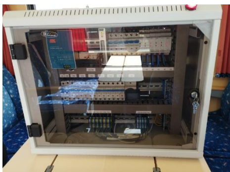
Zariadenie ovládania spúšťania dezinfekcie na diaľku:
